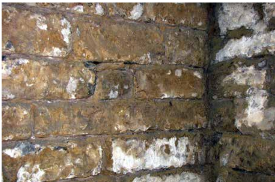
4. Vor der sanierenden Abdichtung war die Natursteinwand zur Gänze durchfeuchtet und mit einem Schimmelfilm überzogen.
