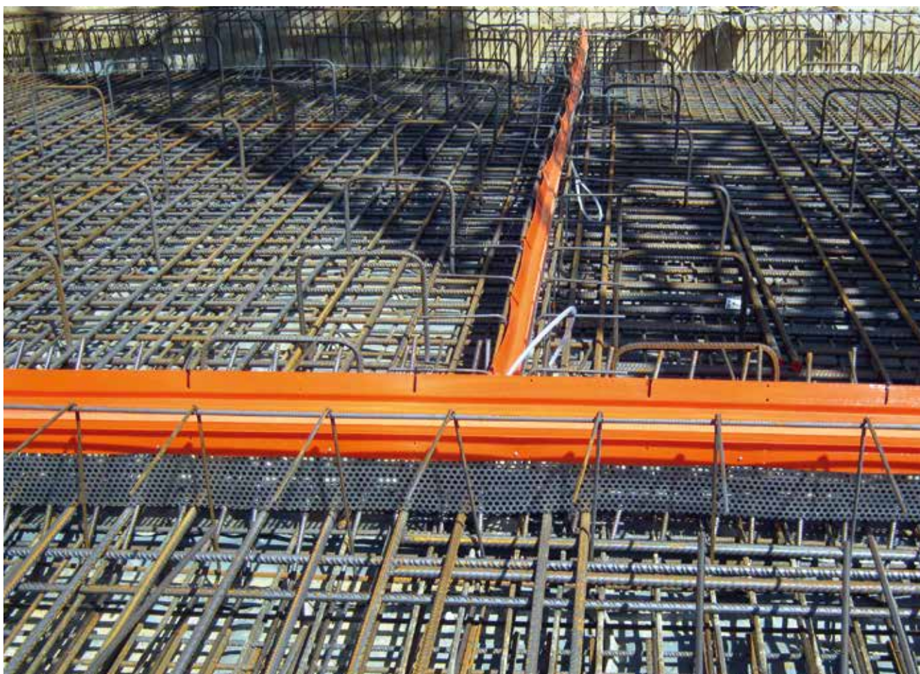
Wirtschaftliche Bauweise trotz nachträglicher Abdichtung der Risse: Im Gegensatz zu einer herkömmlichen Weißen Wanne kommt die Weiße Wanne System Drytech mit einem deutlich verringerten Stahlbedarf aus.
